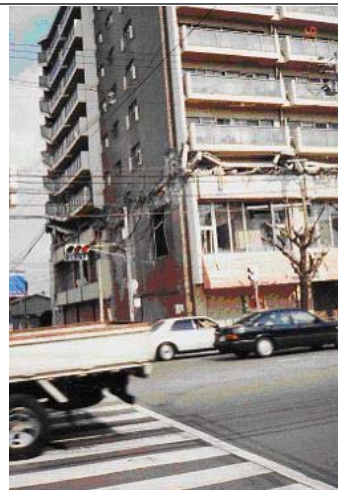
阪神大震災におけるRC3階部崩壊
