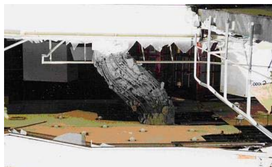
阪神大震災におけるRC造柱の曲げ崩壊
